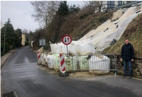
Foto: Commissielid Chris Schrouff ter plekke bij het talud in de Graafstraat te Schin op Geul
